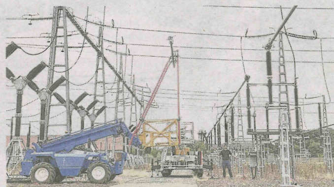
Une fois le transformateur raccordé au réseau, des test seront réalisés pendant deux mois, avant la mise en service définitive..
